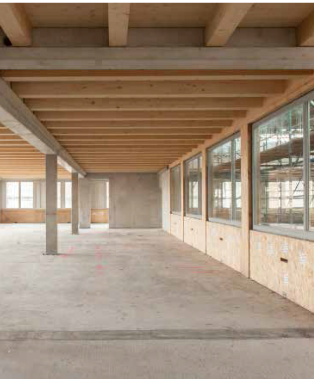
Rohbau des zweiten Obergeschosses mit einem Tragwerk aus Stahlbeton, Holz-Beton-Verbunddecken und einer Holzrahmenfassade.
